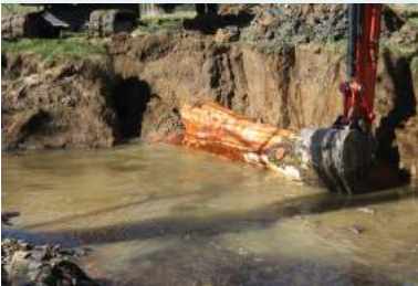
Hanfbach in Hennef: Sohlgleicher Einbau von Holzstämmen als Strömunglenker. Ziel ist auch die Sicherung des Ufers.
